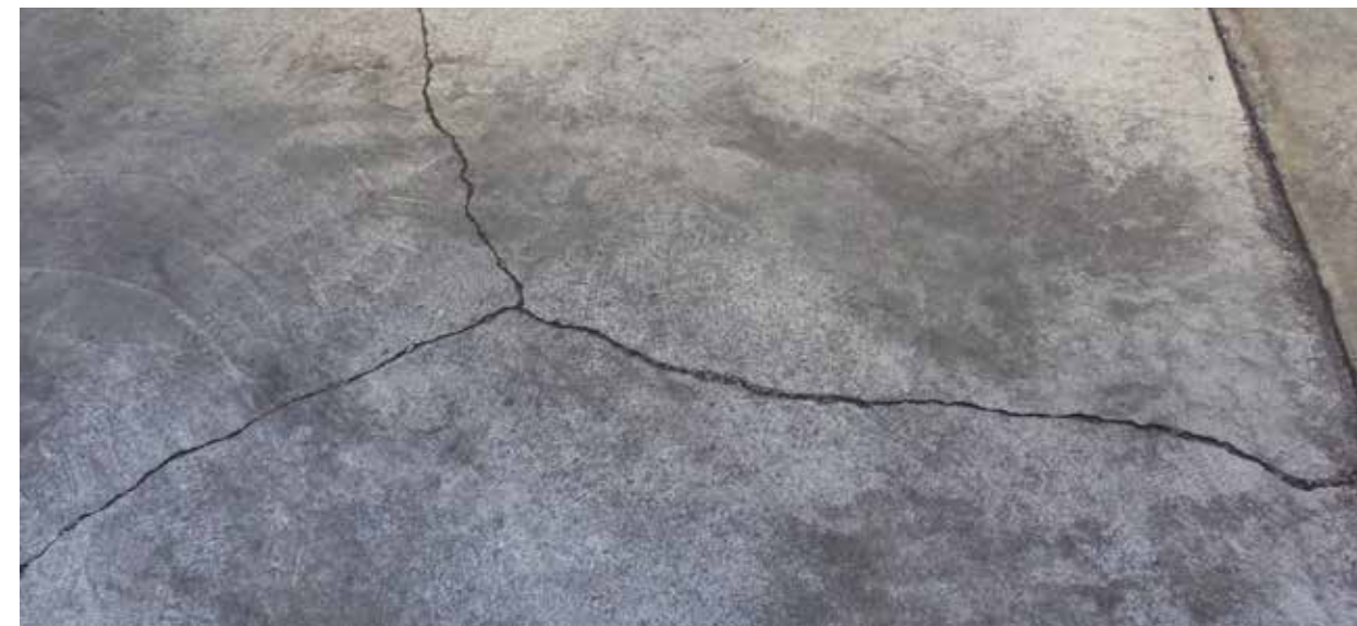
Příklady praskání v betonové podlaze
